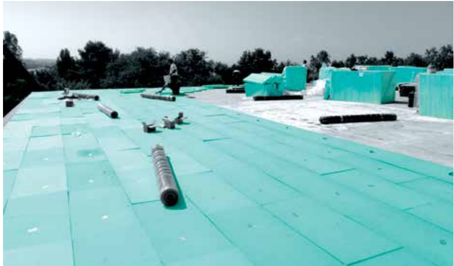
Zväčšenie strešného sklonu budovy s FIBRANxps INCLINE a zároveň tepelná sanácia plochej strechy.
