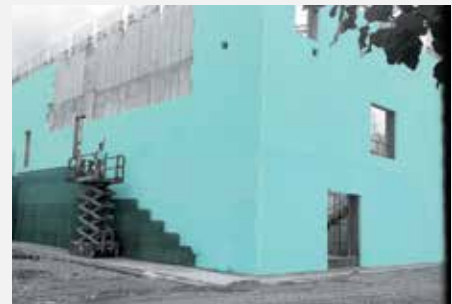
FIBRANxps MAESTRO ako sendvičová izolácia; fázy vonkajšej časti fasády z pohľadového bieleho betónu.
